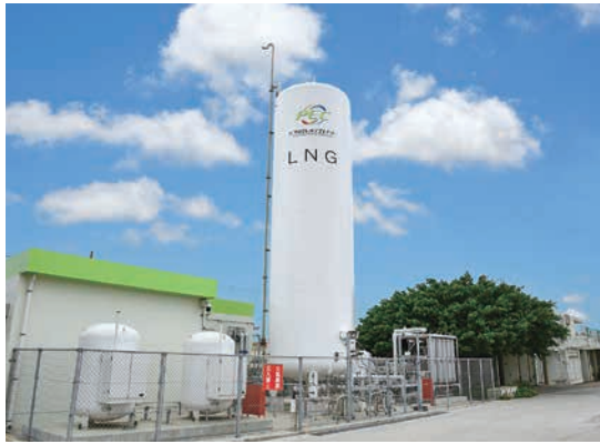
沖縄電力本店構内に設置されたサテライト施設
