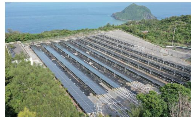
▲渡嘉敷太陽光発電所全景(空撮)
